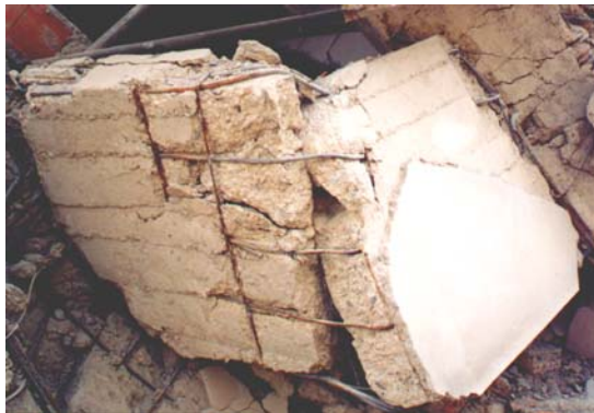
Çay / Düşük beton kalitesi yanı sıra yetersiz donatılı kolon kesiti (13cm en)
