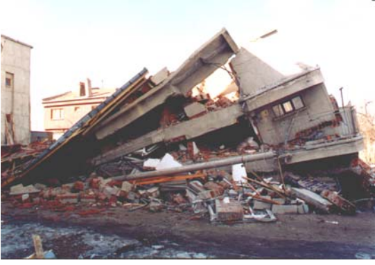
Çay / Karkas ve yığma yapım sınıfına girmeyen sistemsiz bir yapının çökmesi
