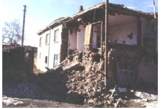
Sultandağı / Kerpiç yapım sisteminde olmaması gereken konsol, cephelerin yıkılmasına neden olmuştur
