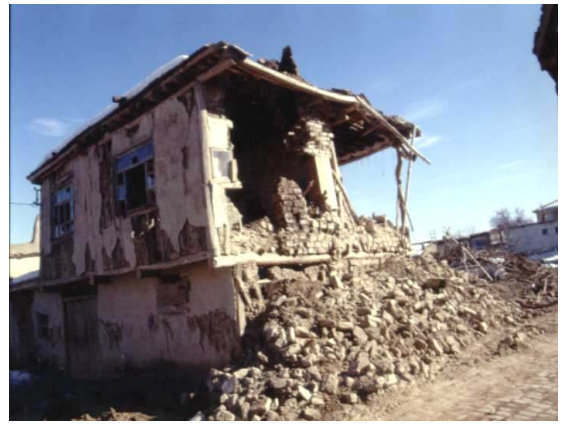
Sultandağı / tamamen yıkılan konsol cephe
