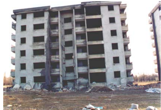
Çay / Yumuşak kat nedeniyle zemin katının çökmesi
