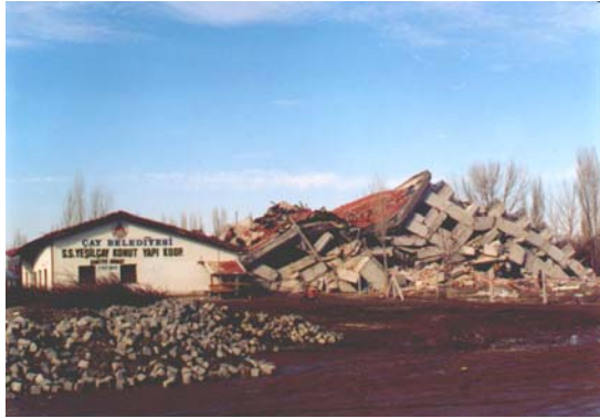
Çay / Taşıyıcı sistemin tamamen çökmesi
