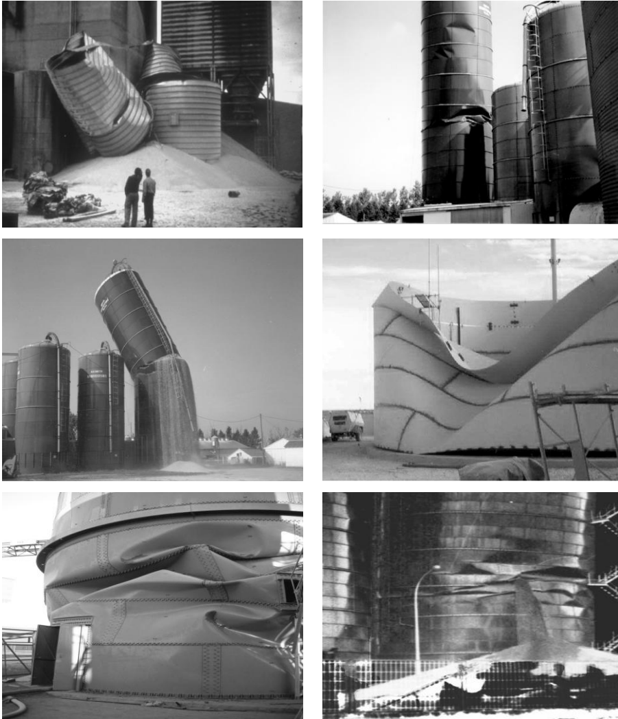
Şekil 5. Silo yapım hataları (Carson, 2008; Rotter, 2008).
