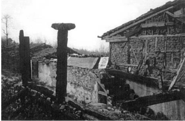
Resim 15: Elektrik Konağından Yanarak Yok Olmuş Bir Yapı Enkazı
