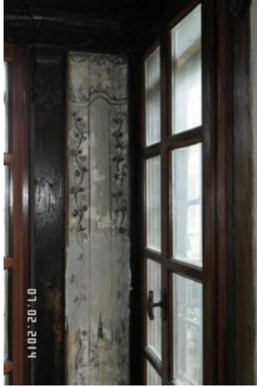
Resim 18: Hanımağa Konaęı, Bařoda, Pencere Aralıęı Bezemesi
