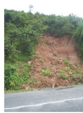
Foto:14 Yol kenarlarında oluşan küçük heyelanlar.
