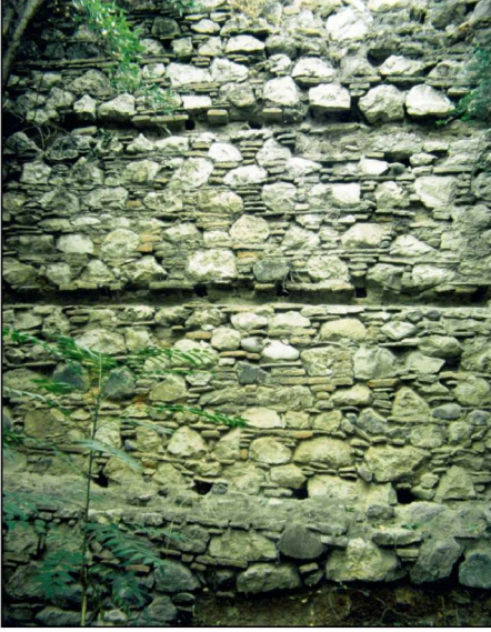
Resim 11: Semâhane beden duvarındaki hatlı ve kırıleme izleri.
