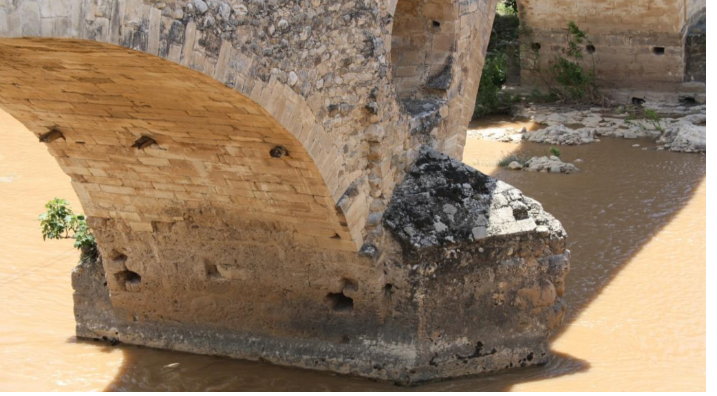
Fotoğraf-11. Kravga Köprüsü sel yaran.
