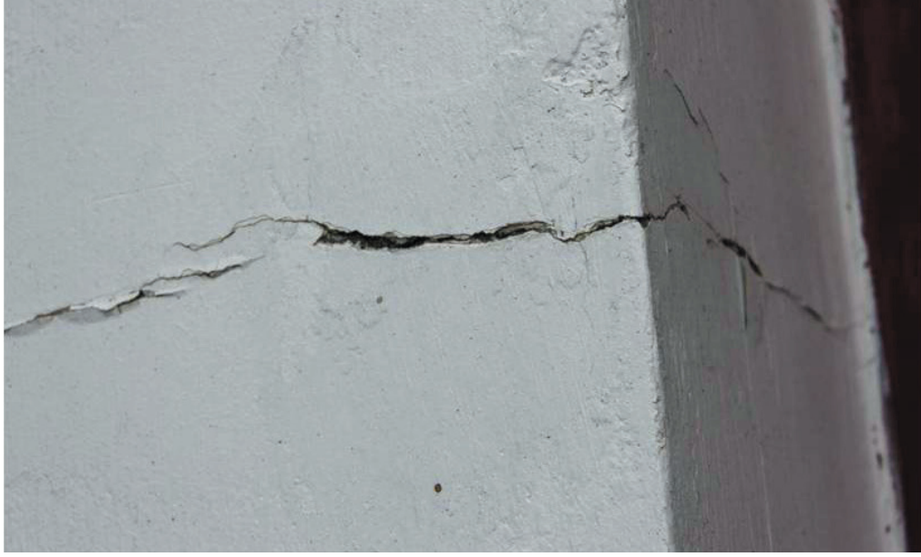
Müze Duvarlarındaki Çatlakları Gösteren Bir Görüntü
