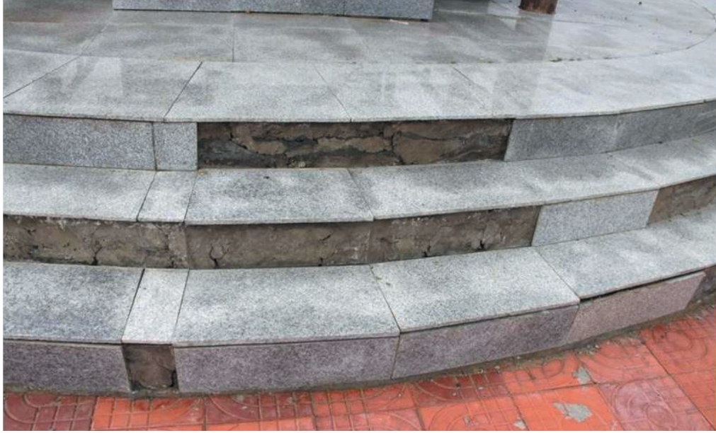
Yapımının Üzerinden Bir Yıl Geçmeden Bozulup Dökülen Döşemelerin Görüntüsü
