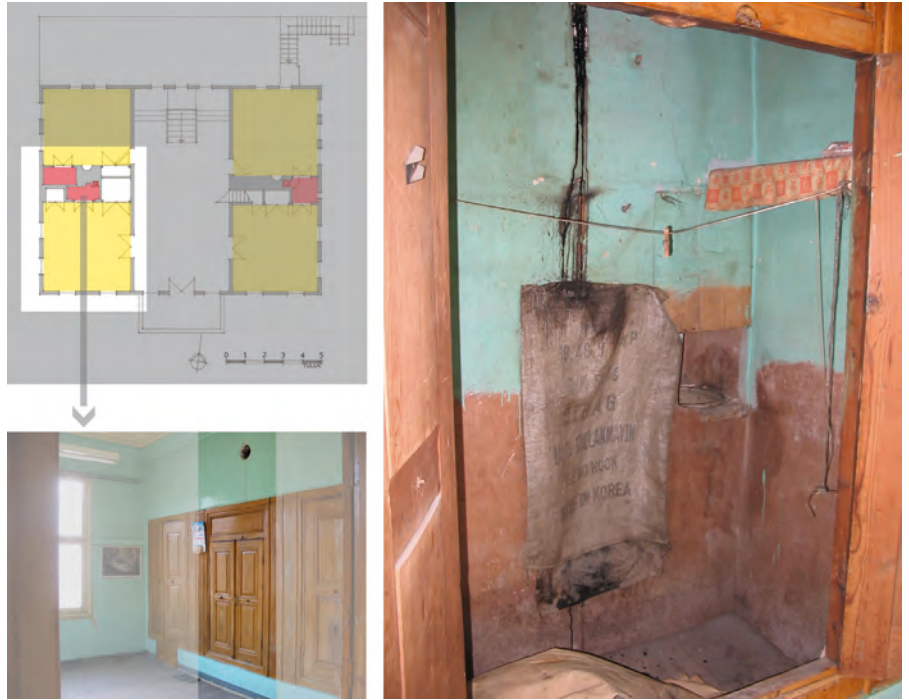
Resim 18. Hanoğulları Konağı üst kat güney-batı köşesindeki oda gusülhanesi (Rölöve ve foto: Ö.İ. Tuluk).
