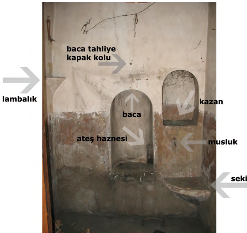
Resim 16. Hanoğulları Konağı zemin kat güney-batı köşesindeki oda gusülhanesi (Rölöve ve foto: Ö.İ. Tuluk).
