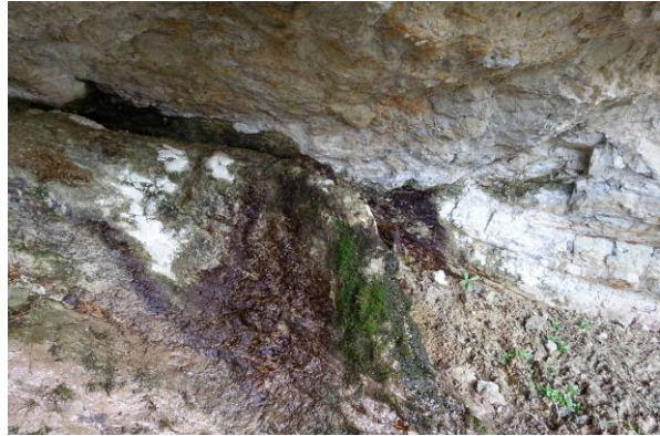
Şekil 8: Çatlaklar arasından sızan zemin suyu.
