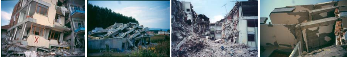
Fotoğraf 5. 6. 7. 8. Marmara Depremlerinde Betonarme Yapılarda Ortaya Çıkan Ağır Hasar ve Göçmeler (N. Akıncıtürk Arşivi)
