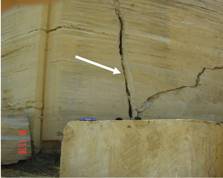
Şekil 4. Sarı travertenlerdeki açılma çatlakları
