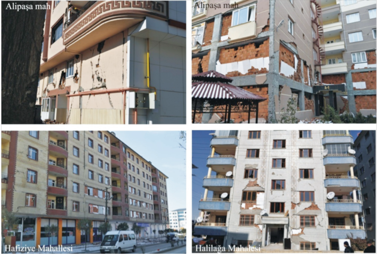
Şekil 10. Hasar derecesinin yüksek olduğu mahallelerden görünüm.
