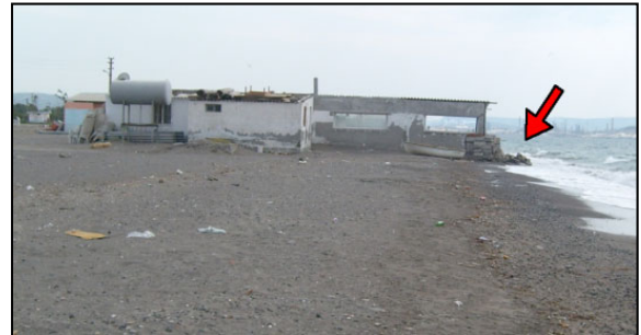
Şekil 4. Güzelhisar deltası kıyılarında oluşan kıyı erozyonu sonucu temeli su altında kalan baraka. Yıkılma tehlikesi ile karşı karşıya kalan barakanın duvarları taşlarla desteklenmiştir.
