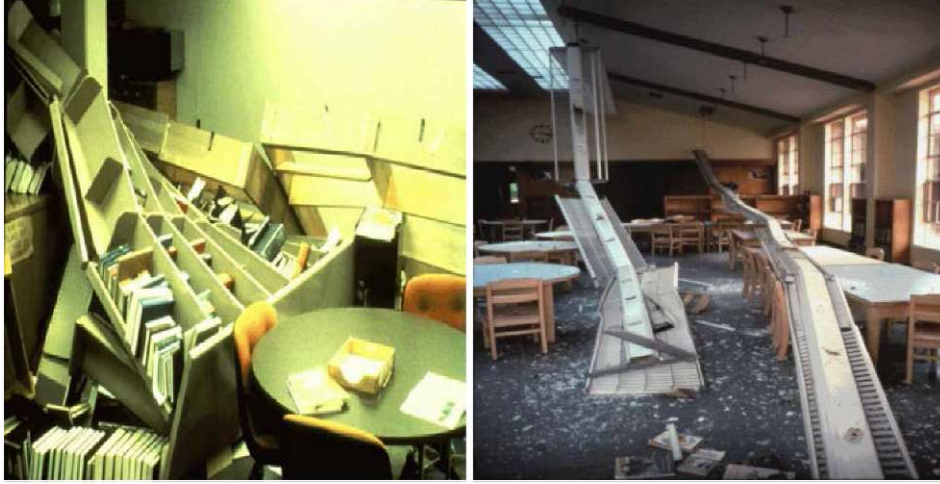
Resim 1: 1980 Livermore Depremi Lawrence Livermore Kütüphanesi'ndeki yapısal olmayan hasar ( Kaynak: USGS-IBHS,1999)-solda ve 1983 Coalinga Depremi Junior High School'daki yapısal olmayan hasar ( Kaynak: EERI, IBHS,1999)-sağda
