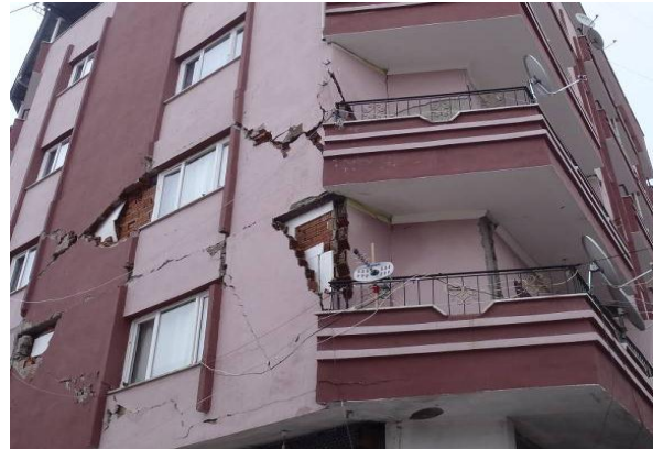
Şekil 23: Van, Merkez, Hatalı yalıtım uygulaması sonucu yıkılan tuğla duvarlar
