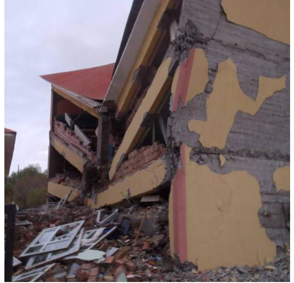
Şekil 21: Gedikbulak Köyü, kat seviyesinden ayrılmış perde elemanı ve binanın göçen perdesiz kısmı
