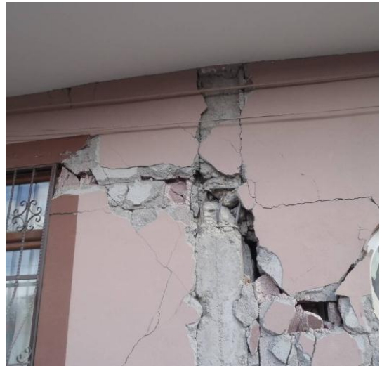
Şekil 17: Van, Merkez, Kısmi duvar yıkılmalarının neden olduğu kısa kolon durumu ve buna bağlı kolonda ağır kesme hasarı
