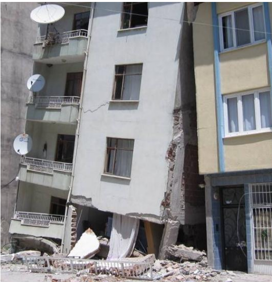
Şekil 5: Simav merkezde zemin katı göçmüş bir bina.
