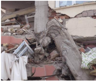
Şekil 14: Erciş, Merkez, Güçlü giriş zayıf kolon davranışı ağır hasar almış kolon üst ucu
