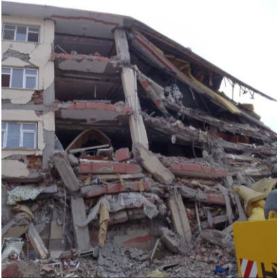
Şekil 13: Erciş Merkez, birleşim bölgesi hasarı ve bu sebeple yıkılmış bina
