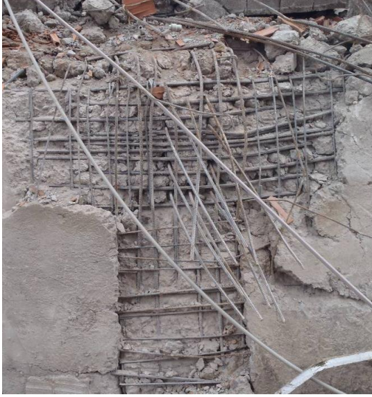
Şekil 18: Erciş, Merkez, ağır hasarlı birleşim bölgesi ve kötü beton nedeniyle bütünleşememiş beton-donatı karışımı
