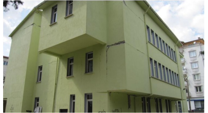
Şekil 7: Simav Halk Eğitim Merkezi Binası kirişsiz kapalı çıkma hasarı.
