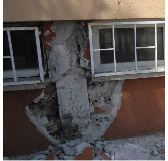
Şekil 6: Simav Cumhuriyet Lisesi binasında bant pencerelerin neden olduğu kısa kolon hasarı.
