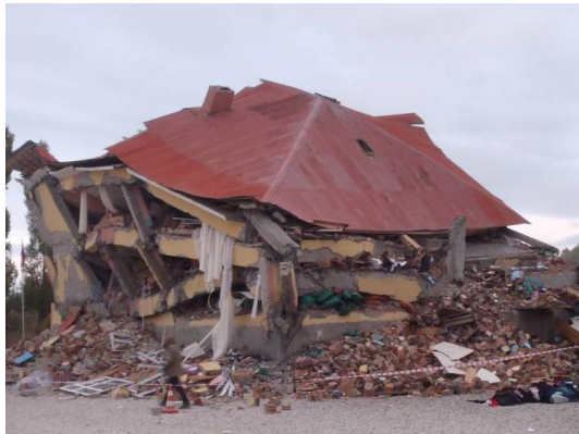
Şekil 20: Gedikbulak Köyü, Van depremi sonucu yıkılmış ilköğretim binası
