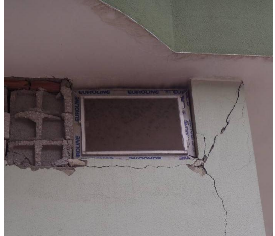
Şekil 16: Erciş, Merkez, Bant pencere nedeniyle kesme hasarı almış kolon elemanı.
