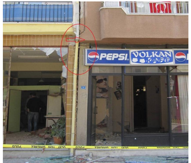
Şekil 8: Simav merkezde çekiçleme etkisi ile düşey ekseninden kalıcı olarak kaymış bina.
