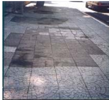
Şekil 17. Mimar Sinan Caddesi'nde bakımsızlık nedeni ile tahrip olmuş kaldırım [Ori.]
