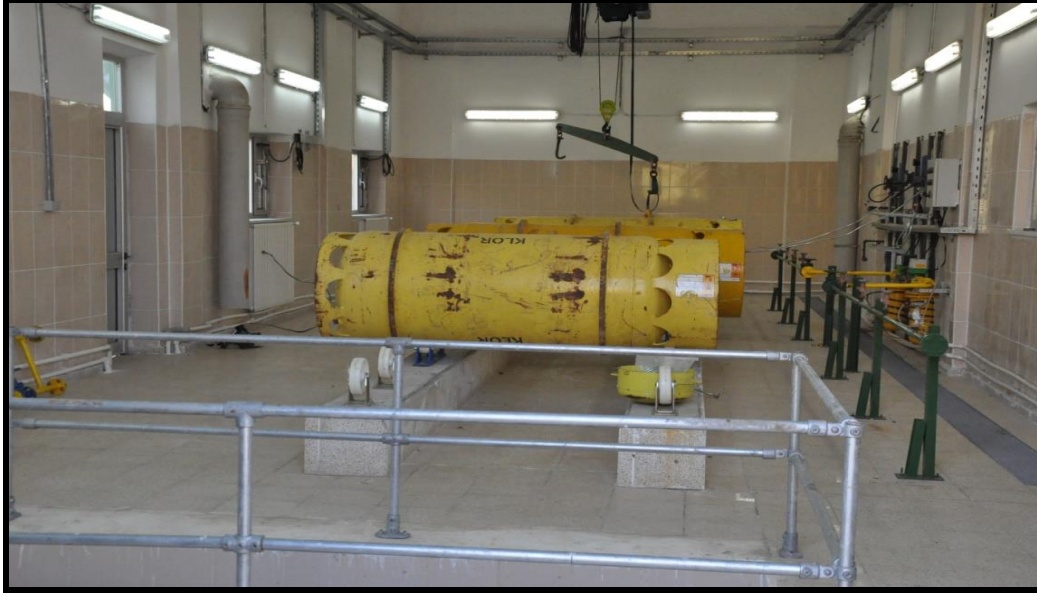
Fotoğraf 5. Arıtma Tesisindeki Klor Tanklarından Bir Görünüm
