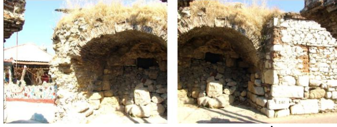
Resim 17. Sivrihisar Kapısı'nın (1 Nolu Kapı) Kale İçindeki Bozulmaları
